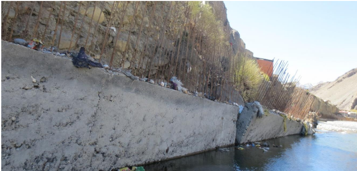
Abb. 4: Unterspülung einer Zementmauer an der Kali Gandaki (Foto: R. FLEISCHMANN, 2013)
